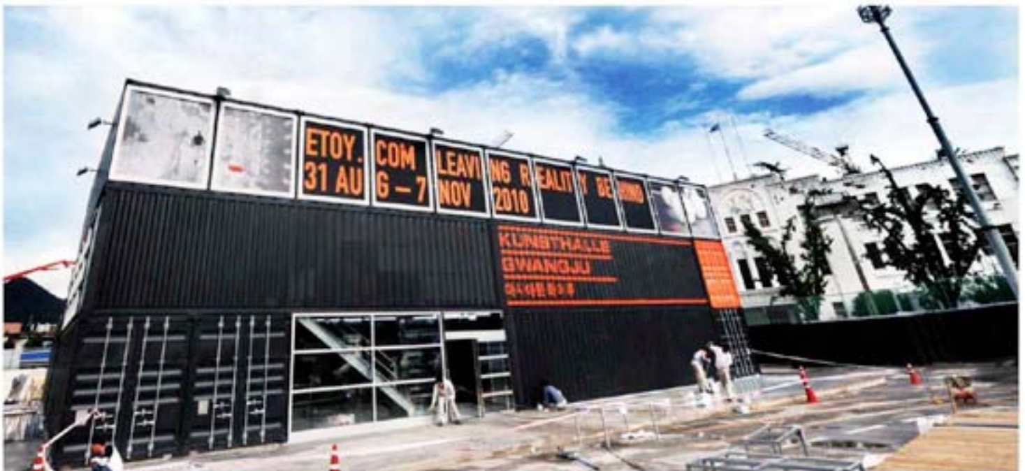
아시아문화마루 오늘 개관 광주비엔날레 등 현대미술 축제의 향연을 앞두고 분위기가 고조되고 있는 가운데 '아시아문화마루-콘스트할레 광주' 개막을 하루 앞둔 30일 국립아시아문화전당 내 민주광장에서 관계자들이 마무리 작업을 하고 있다. '콘스트할레 광주'는 건축면적 520㎡(158평)에 연면적 1019㎡(309평)의 컨테이너 박스 29개로 쌓아 만들어져 마치 성벽처럼 특이한 모양을 형성하고 있다. /김재리 기자 kk@kdaily.com
